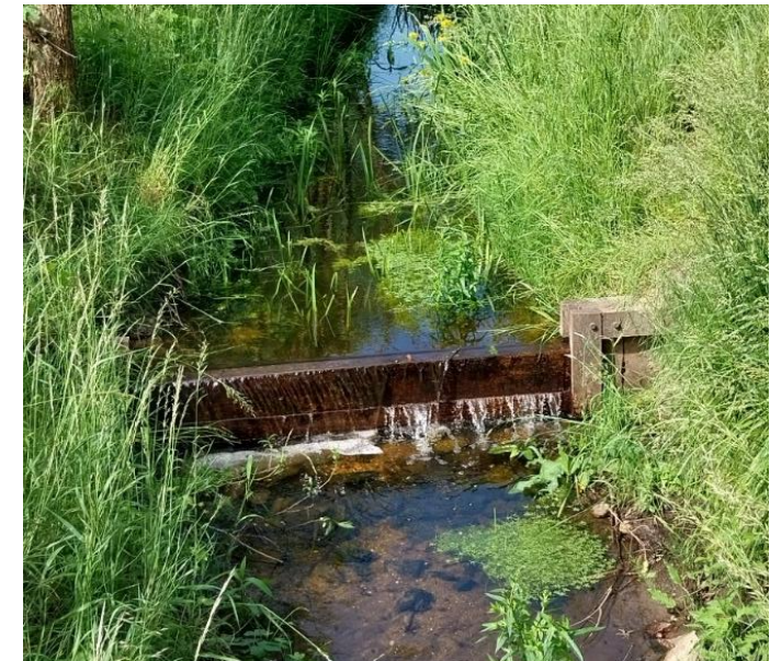
Stauanlage in der Wipperau, Uelzen (Quelle:DFU)
